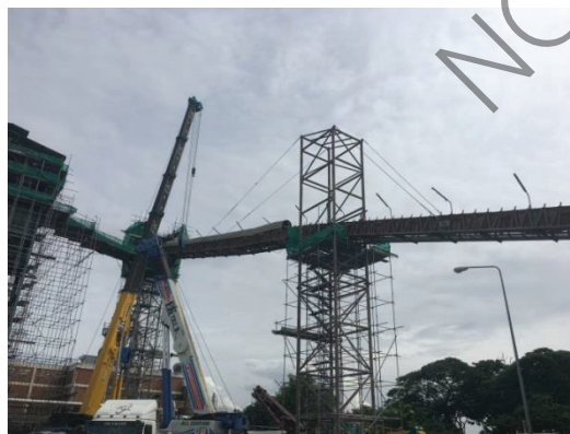
รูปที่ 2 โครงสร้างสายพานลำเลียงที่ถูกไฟไหม้
